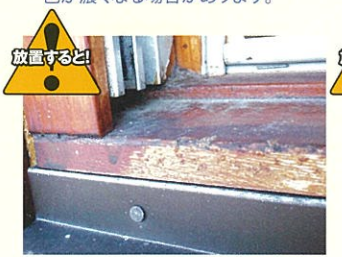
放置すると塗膜の劣化によりひび割れ等が生じ、雨水が浸入してしまいます。
