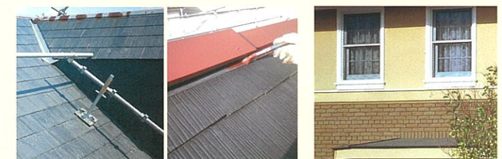
足場組み、錆落とし、錆止め、中塗り、上塗りの手順で工事を進めます。
